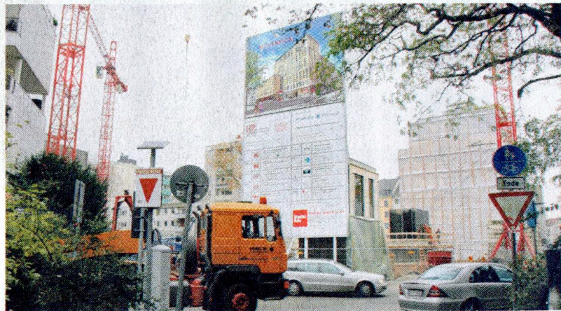
Hier soll 2008 das Hotel „Mövenpick am Hofgarten“ eröffnen. Wegen eines Beschlusses des Verwaltungsgerichts wurde ein Baustopp verhängt. RP-FOTO: GABRIEL
